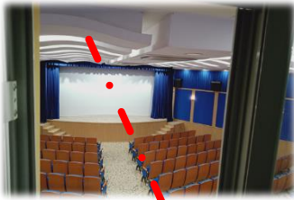
Plafond de salle de projection avec Un nouveau système de ventilation
