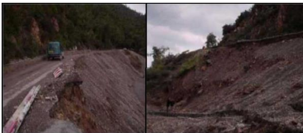
Figure 1.13 Glissement de terrain de Bejaia sur la route [10]
