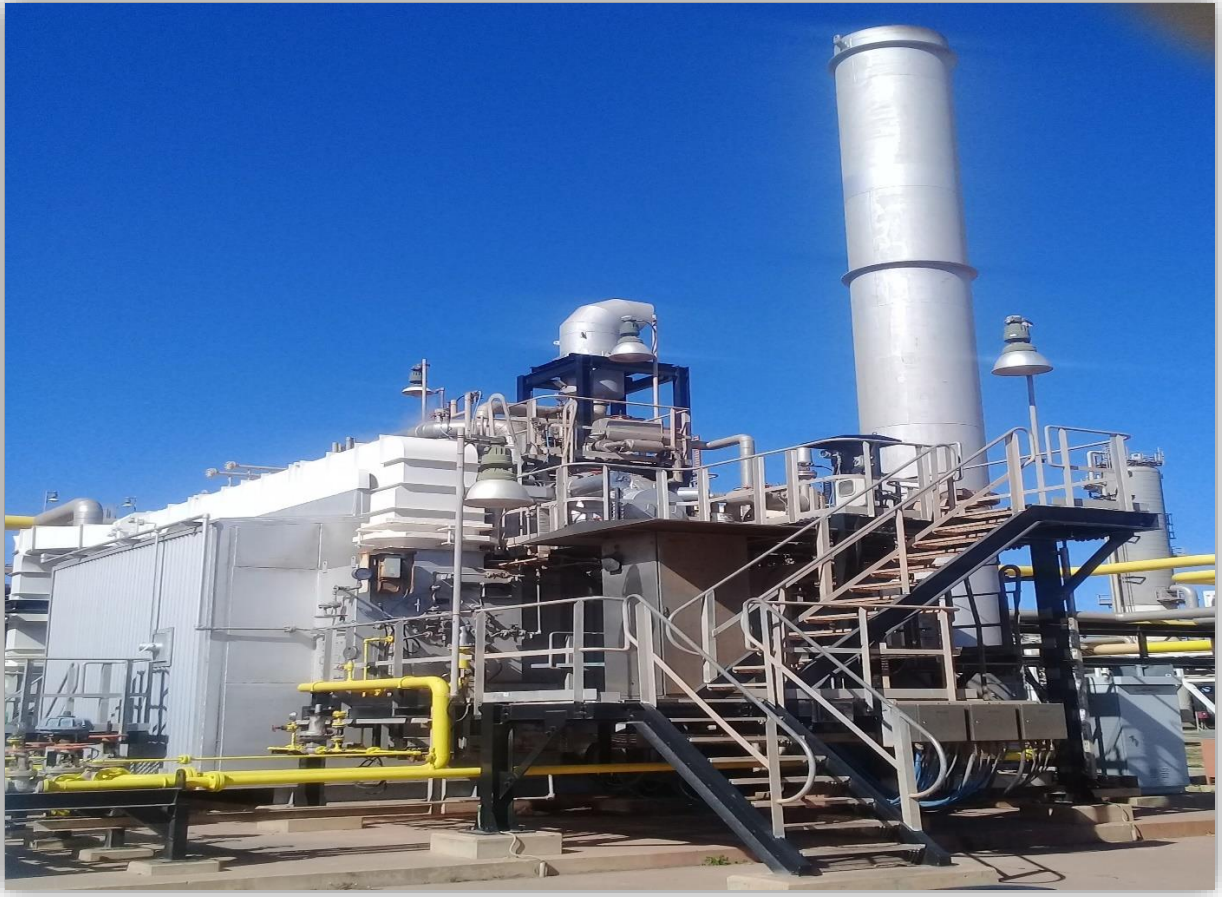
Figure II.3 : Chaudière à tube d'eau du complexe GP1/Z.
