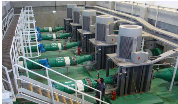
Figure II.3 : Système de pompage de l'eau de mer
