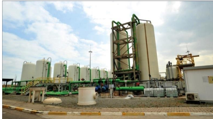
Figure II.2 : Tours de captage et tuyauterie de captage
