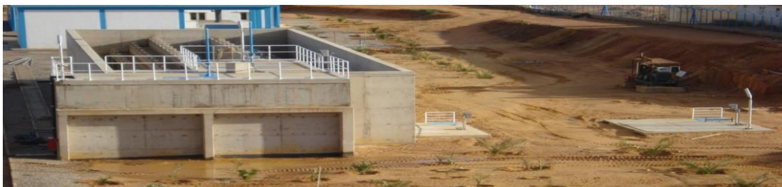
Figure2-2: ouvrage d'entrée d'eau brute
