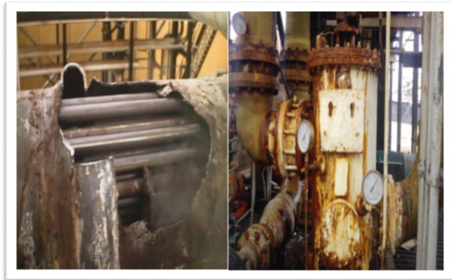
FigureII.15 : Problème de corrosion.
