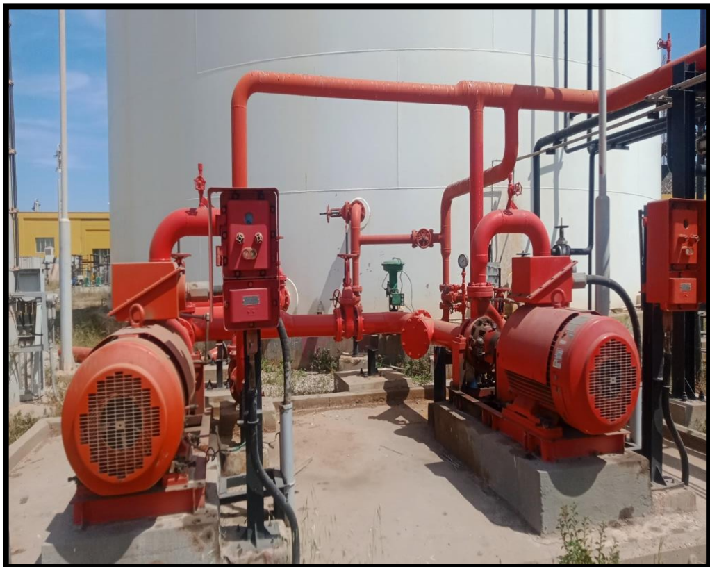
Figure. III.2 : pompe d'eaux distillat.
