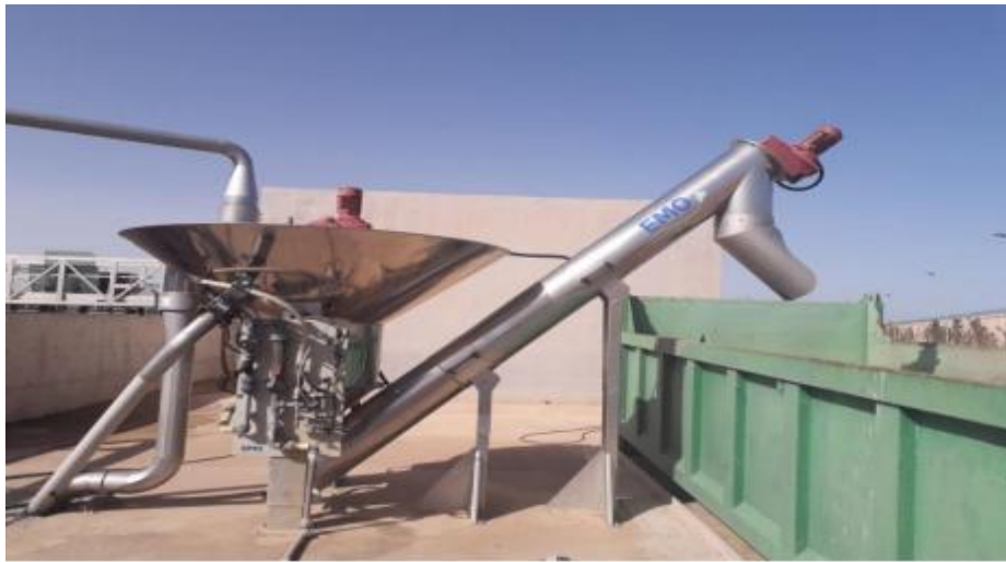
Figure II-9 : Clarificateur de sable.
