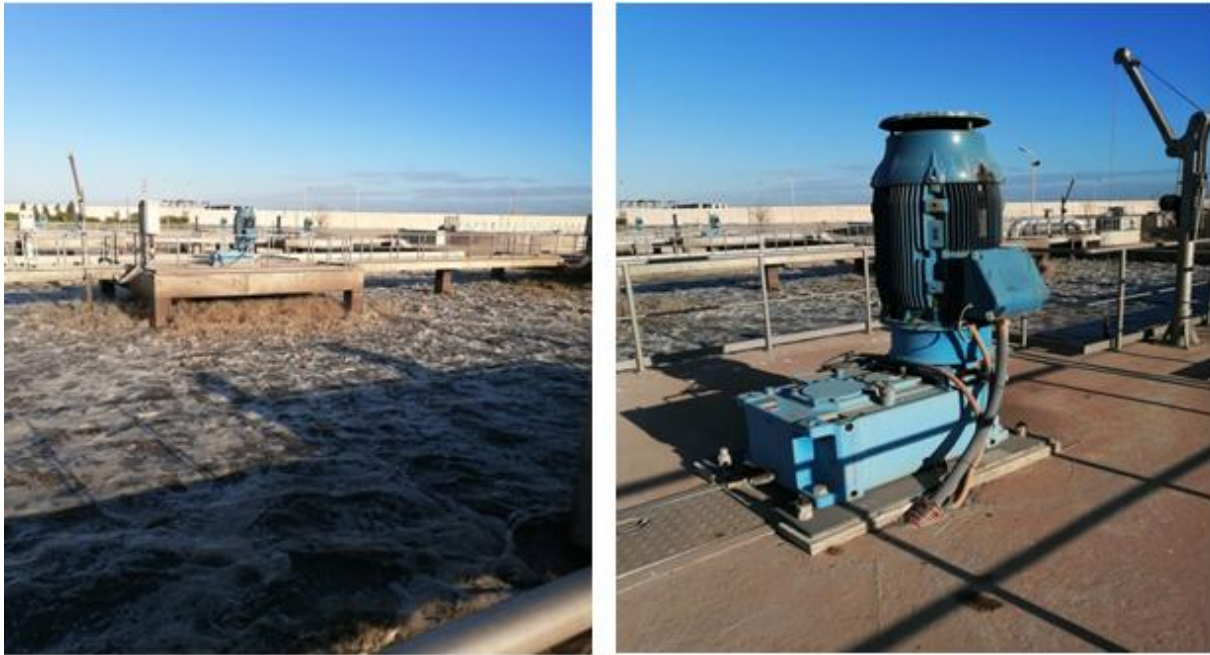
Figure II-12: Bassin biologique (Bassin d'aération)
