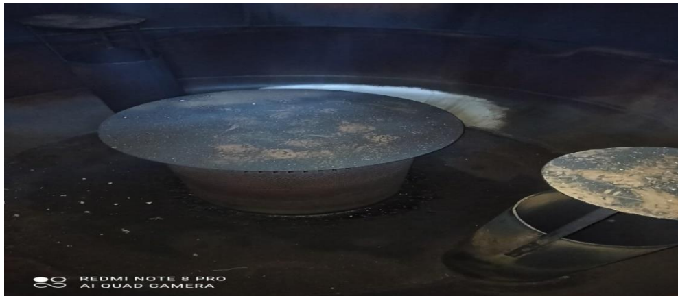
Figure I.10 : Réservoir de stockage de solvant 105T001
