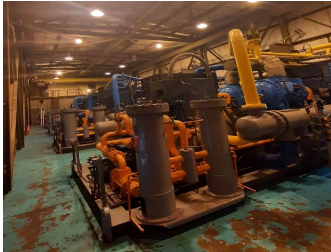
Figure II.1. les compresseur de charge
