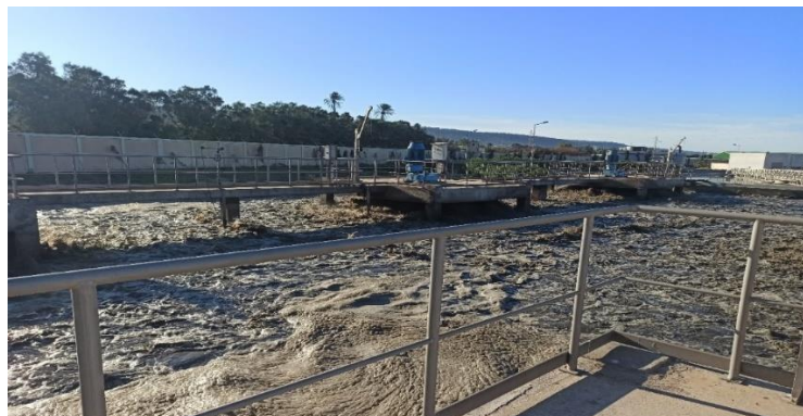
Figure II.6: Bassin biologique (Bassin d'aération)
