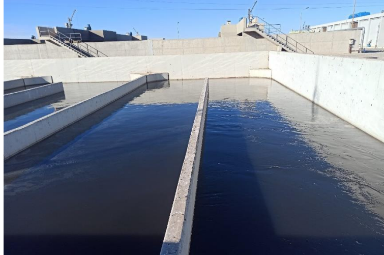
Figure II.8: Bassin de désinfection
