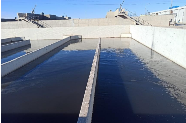
Figure II.8: Bassin de désinfection
