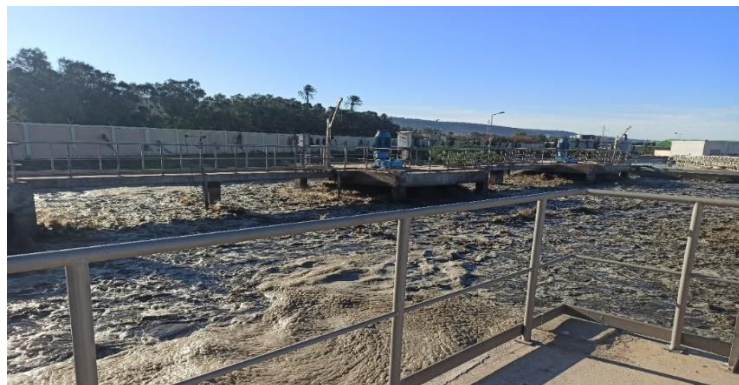
Figure II.6: Bassin biologique (Bassin d'aération)
