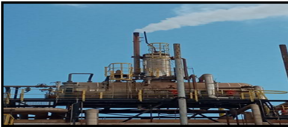
Figure II.16 : Le dégazeur V701 (photo prise le 22/03/2023).
