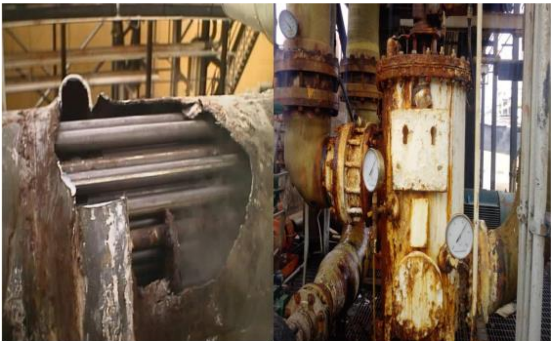
Figure III.2 : Image représentant la corrosion.
