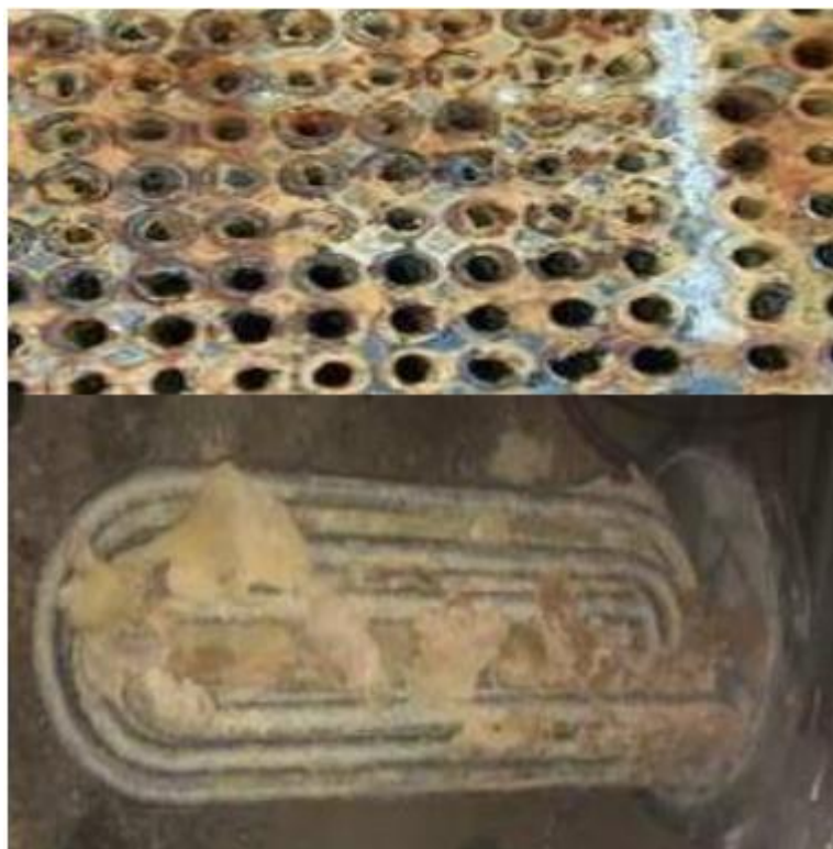
Figure III.1 : Entartrage au niveau du réchauffeur.
