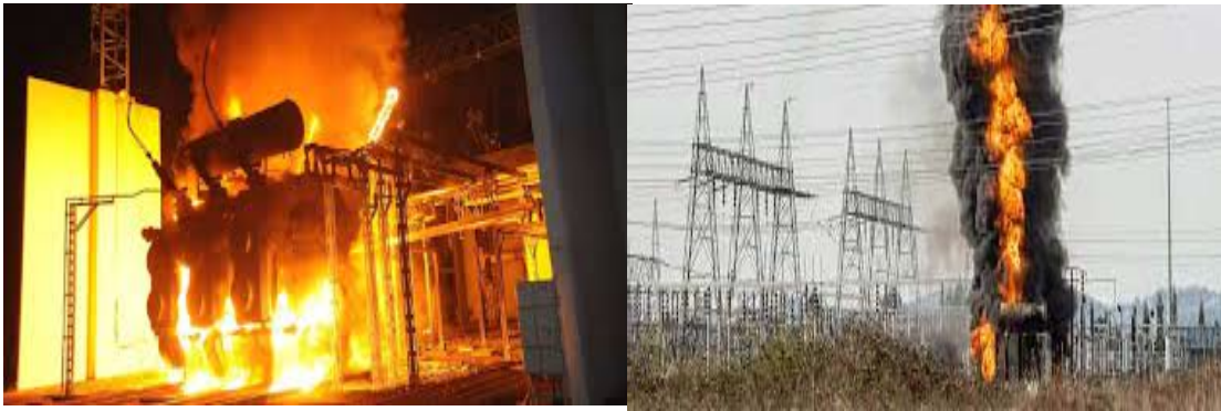
Figure I.8 Incendie causée par un transformateur électrique
