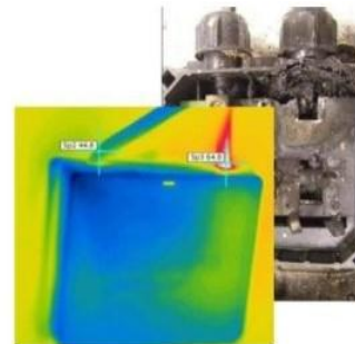
(b) corrosion dans la boîte de jonction
