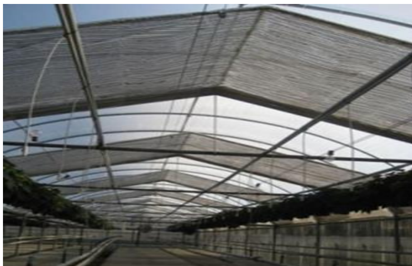
Figure VI 1. Rideau thermique déployé à 50 % dans une serre.
