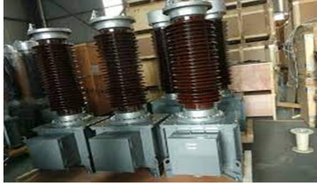
Figure 27: Le transformateurs de potentiel à condensateur
