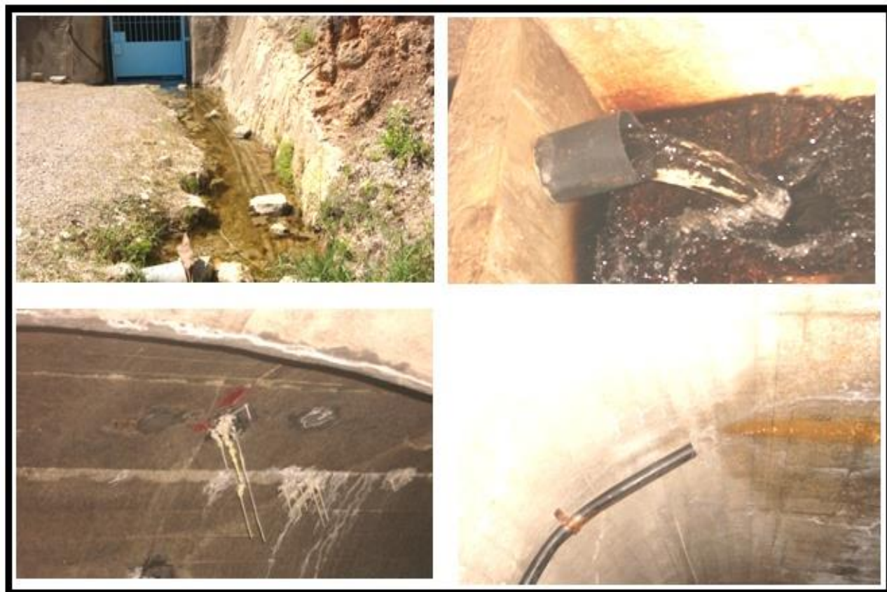
Figure 40 Les fuites d'eau dans la rive droite du barrage de Ain Kahla
