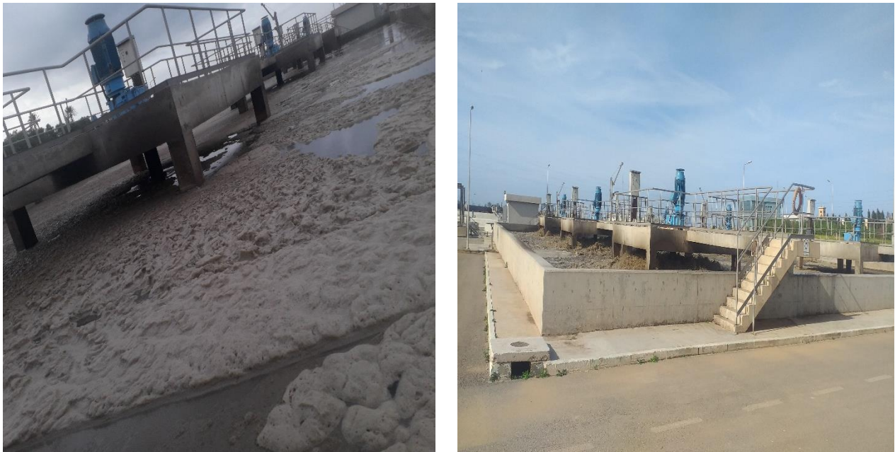
Figure 23: bassin d'aération en état de marche (Aicha, 2023)
