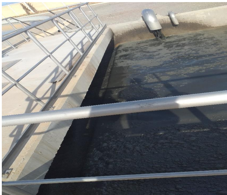
Figure 26: le retour de surverse de l'épaississement vers le bassin aéré (Aicha, 2023)
