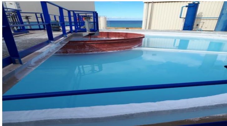
Figure II-15: Saturateur de \text{Ca}(\text{OH} + \text{H}_2\text{O}) [Photo prise au niveau de la station de dessalement de Ténès 2023].
