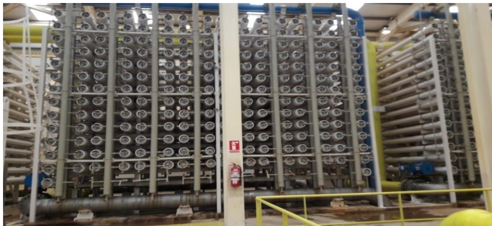
Figure II-13 : Un rack dans le système d'OI
