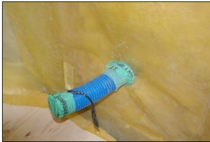
Figure 63: Une Arrivée traversant la membrane d'étanchéité pour le passage des réseaux (Projet Vert, 2021)
