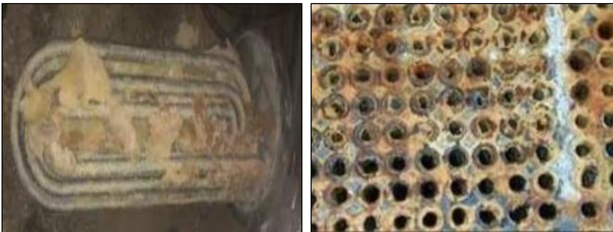
Figure III.1. Entartrage au niveau du réchauffeur.
