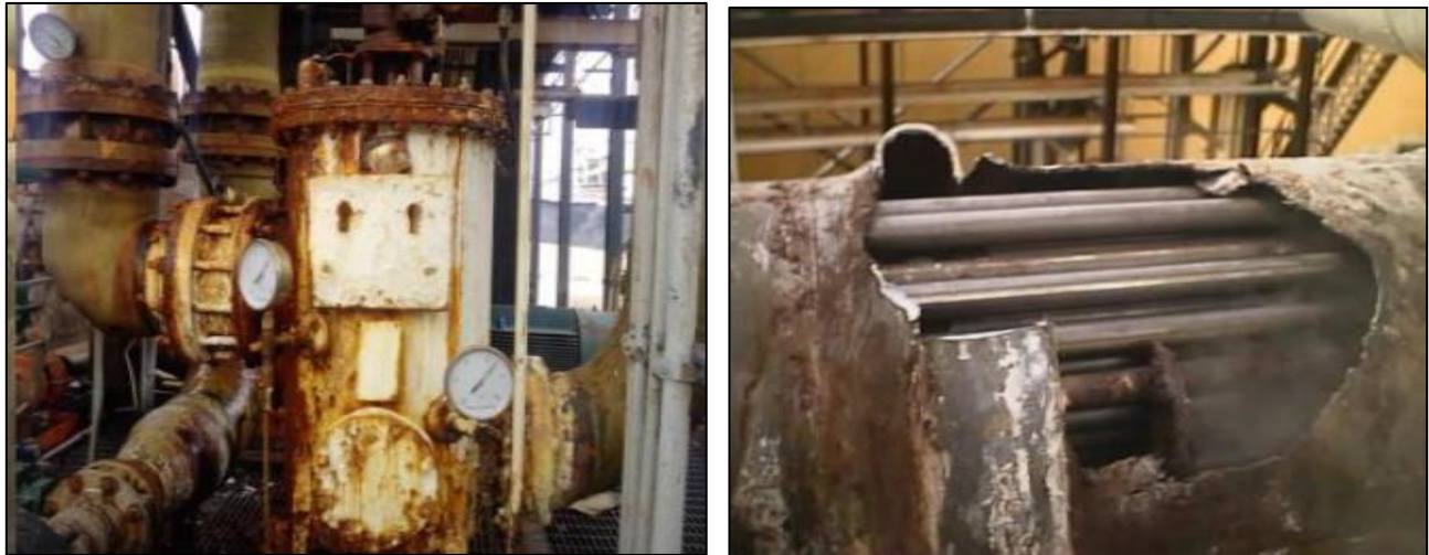
Figure III.3. Phénomène de corrosion
