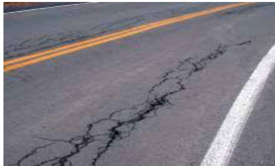
Figure2.5. Dégradation de la couche de roulement d'une route en raison de la remontée d'eau saline
