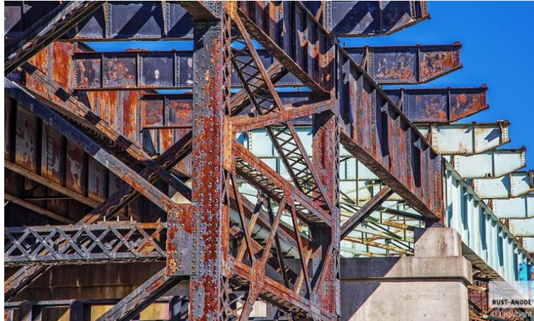
Figure2.8. L'effet de la corrosion sur les structures métalliques
