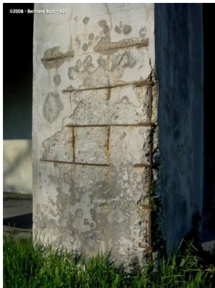
Figure 2.6. Corrosion des armatures d'un poteau béton
