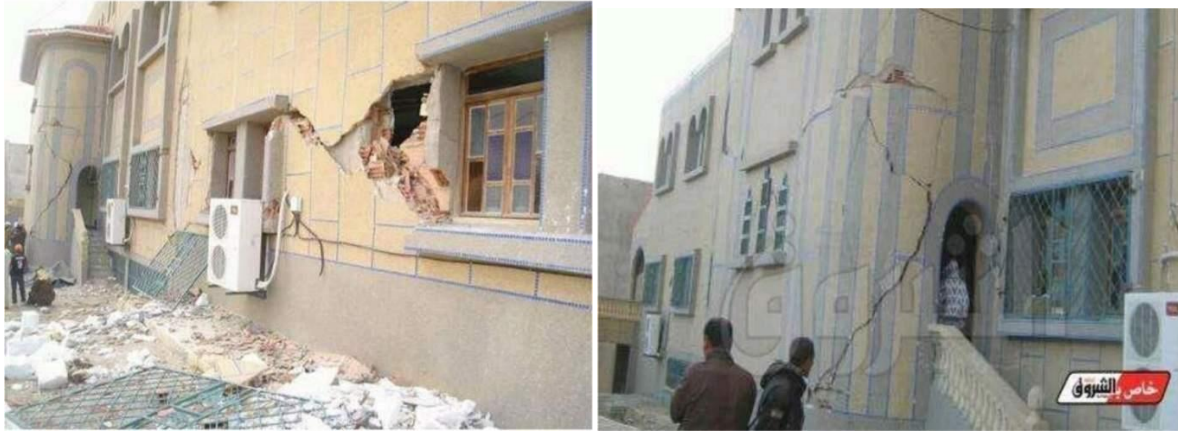
Figure 16: Effondrement de la maçonnerie
