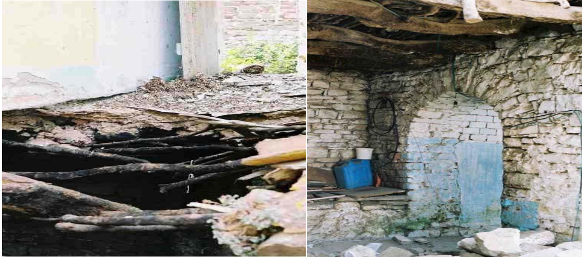
Figure 21: les plancher entrons d'arbre et les sacs faibles (DELLYS)
