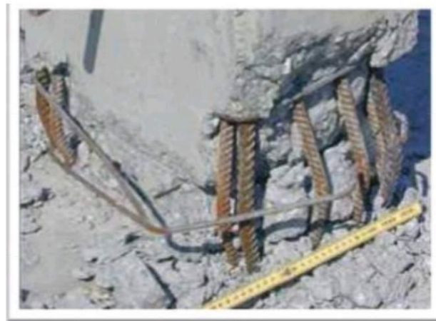
Figure 14: Éclatement du béton et flambement des armatures à la base
