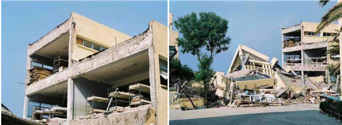
Figure I.20: Poteau fort poutre faible (DELLYS)
