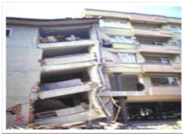
Figure 13: Endommagement et rotation des poutres
