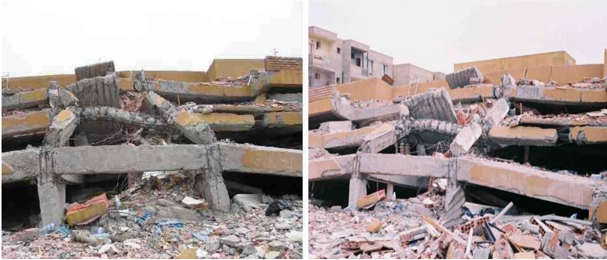
Figure 18: l'effondrement total en millefeuilles (BOUMERDES)
