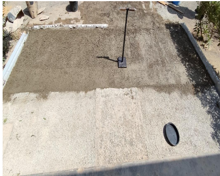
Figure IV- 25 : Damage et mise à niveau du béton drainant.
