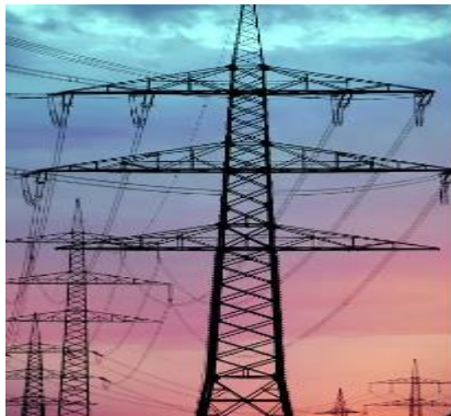
Figure I.1 :Réseau électrique aérien
