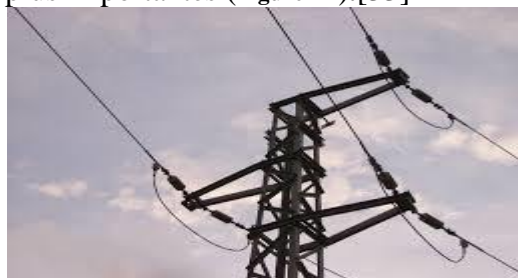
Figure I-2: Lignes électriques aériennes [35]
