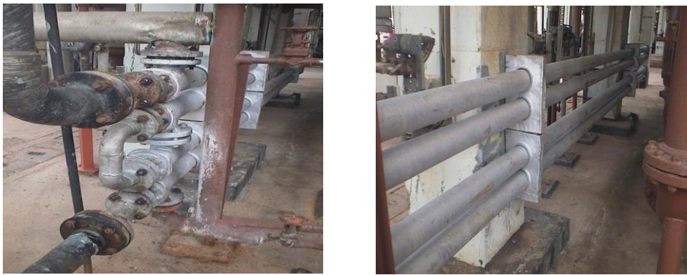
Figure III.1 : l'emplacement du refroidisseur de la gazoline (E.758) dans le train
