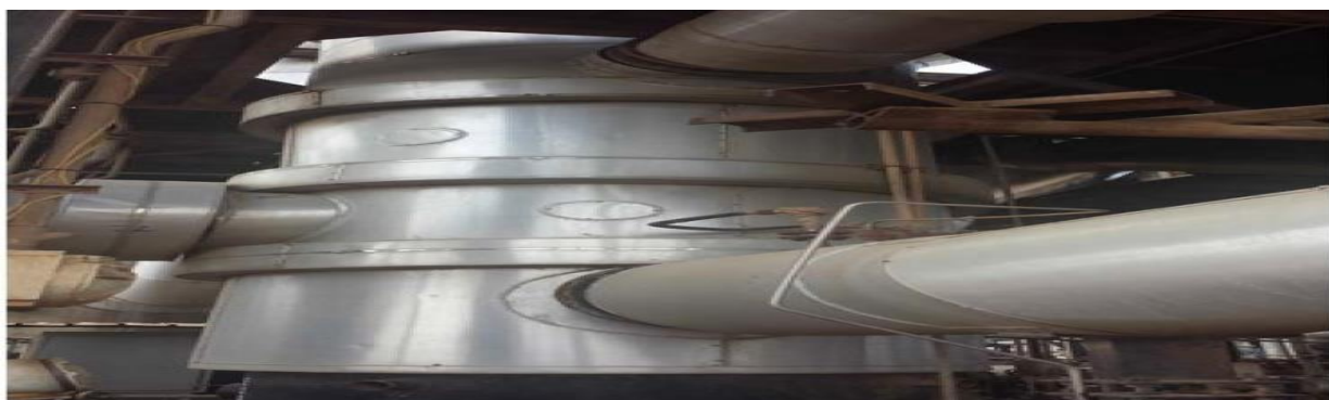
Figure 2 : Echangeur gaz-gaz E102 A/B
