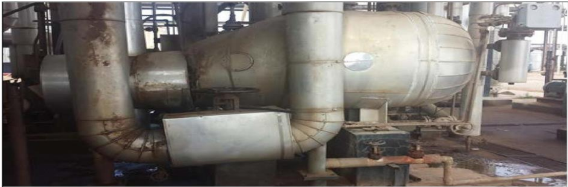
Figure 7: Chaudière de récupération EB101
