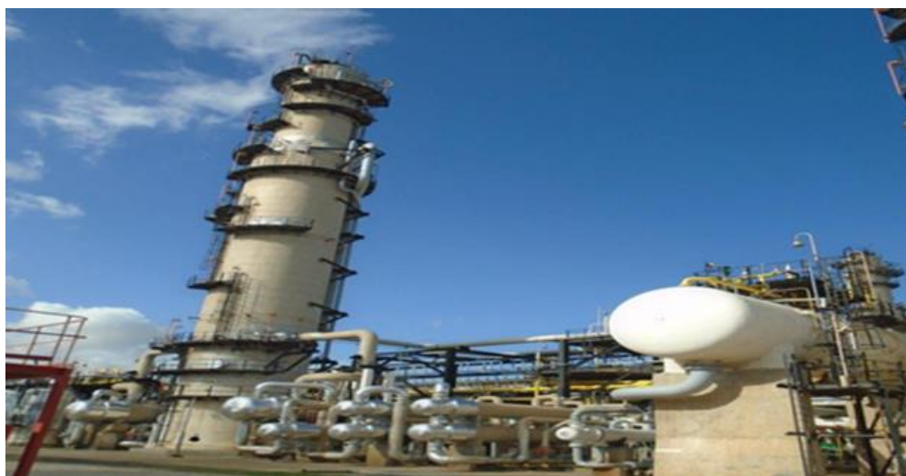
Figure I.8. colonne de séparation (Fractionnateur) .
