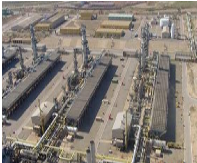
Figure I.4. Les trains de traitement du GPL1/Z.
