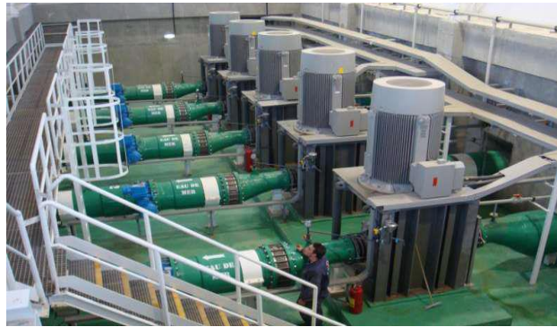
Figure n°18 : Salle de pompage captage
