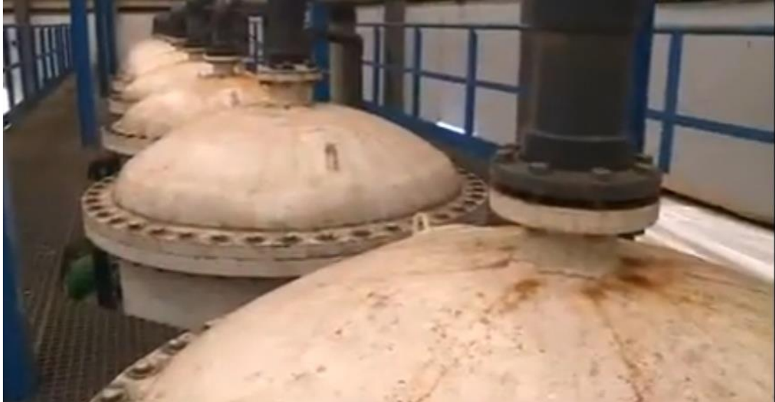
Figure n° 20 : les filtres à cartouches (microfiltration).
