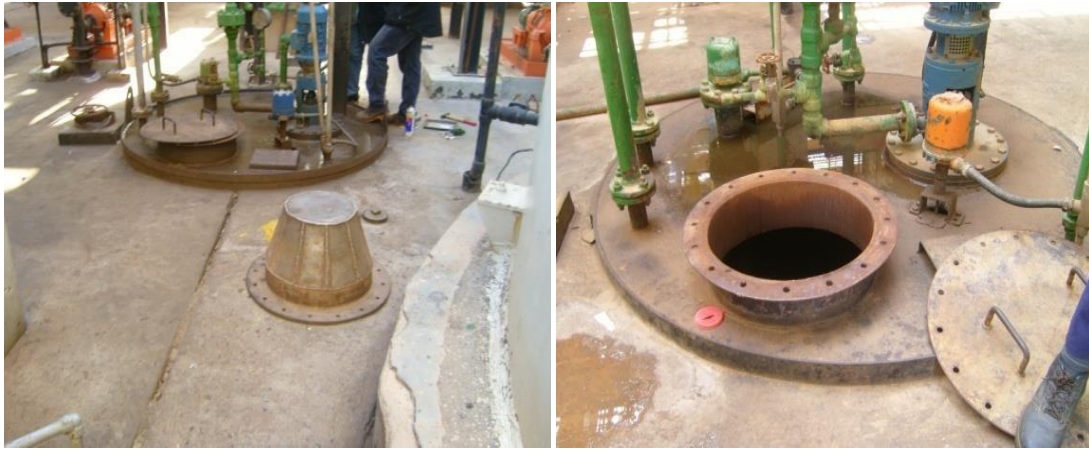
Figure II-4I Absence du filtre dans le puisard
