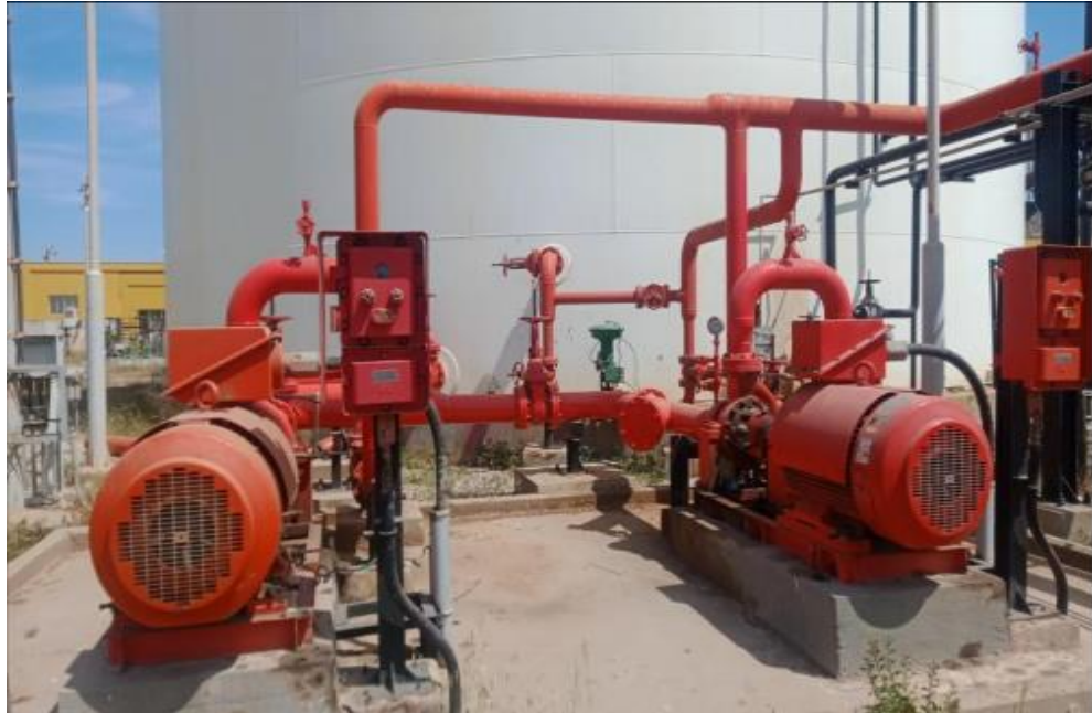
Figure III.2 : pompes d'eaux distillat.
