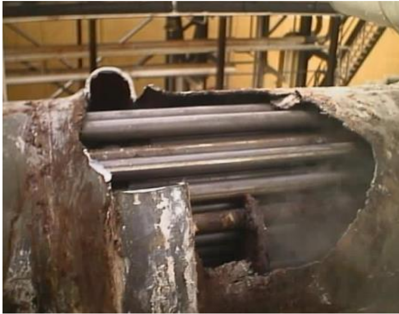
Figure III.5 : obstruction des tubes à cause de la corrosion.
