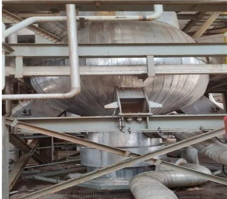
Figure III.7 :photo réel de HP condenseur[20]
