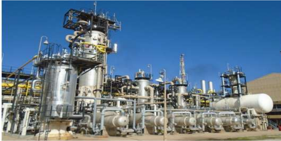
Figure 2. Les équipements de la section de réfrigération
