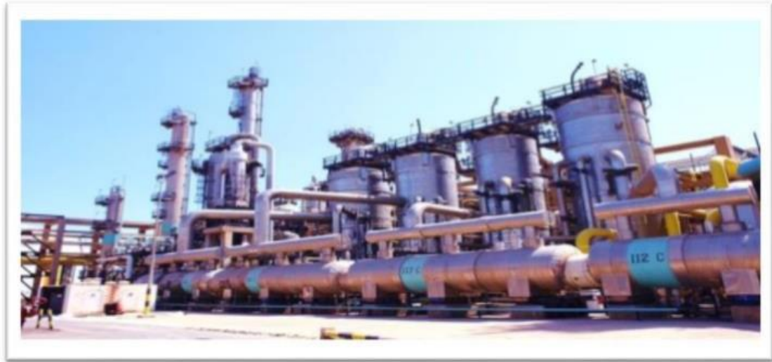
Figure I-6 : Zone des utilités.
