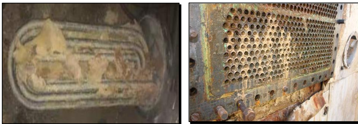
Figure III.10 Entartrage au niveau du réchauffeur
