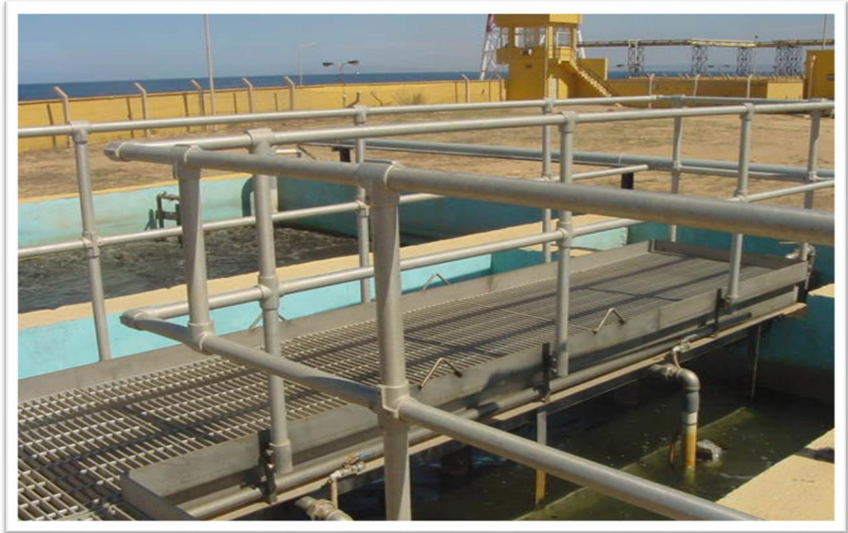
Figure III.1 (b) : station des eaux sanitaires phase I.
