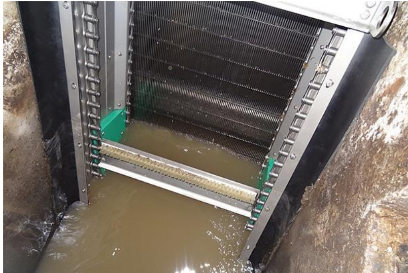
Figure I.03 : Dégrilleur (Feknous et Cheikh.2022)
