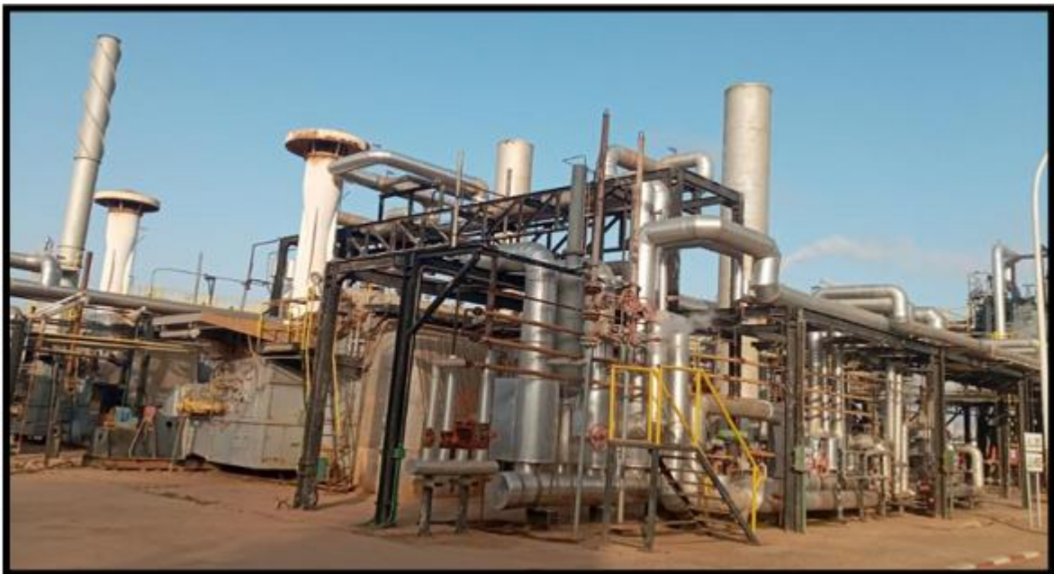
Figure 0-IV:service utilité (photo prise le 06/02/2023) [1]
