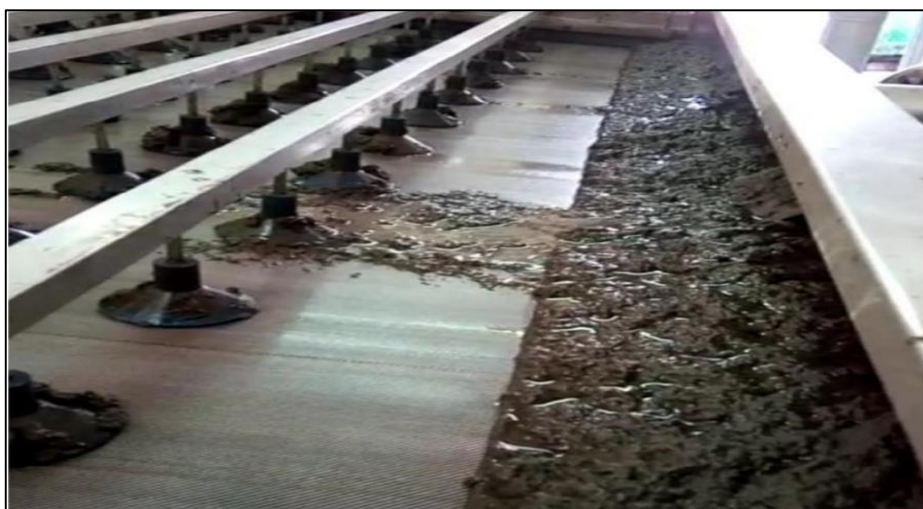
Figure II.5 Epaissement des boues.
