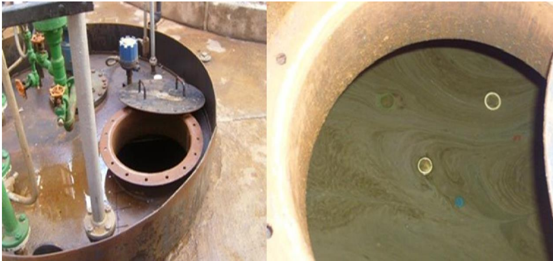
Figure IV.13:Photo du puisard134-F.
