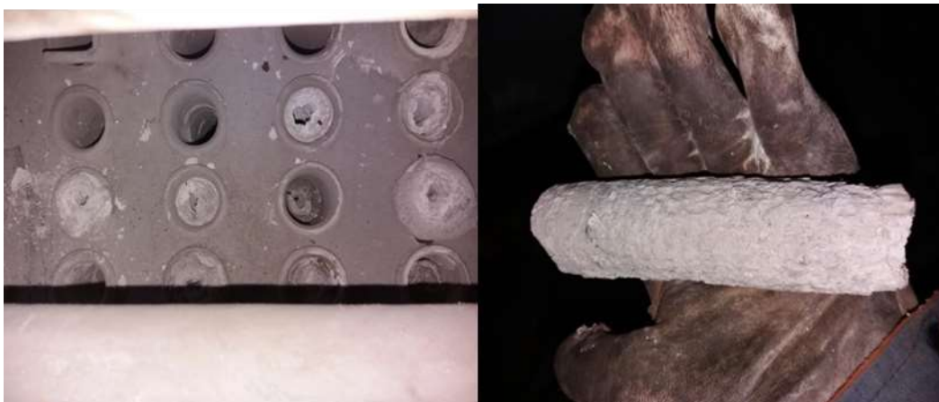
Figure III.6 : Le dépôt dans les tubes de la chaudière
