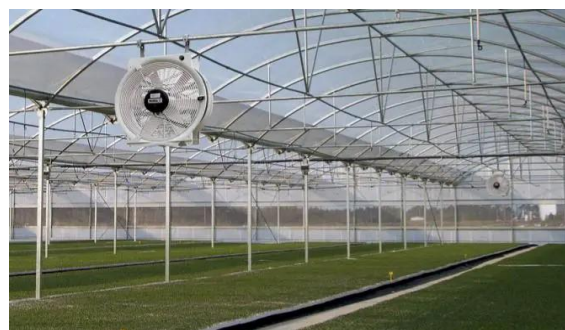
Figure V.5 : Exemple de système d'aération forcée constitué de ventilateurs/extracteurs
