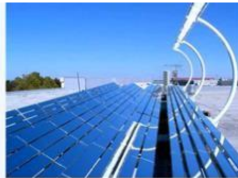
Centrales à miroirs Fresnel
