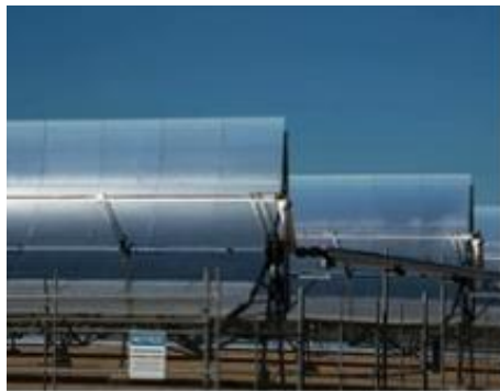
Centrales à miroirs cylindro-parabolique
