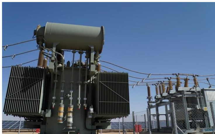
Figure II.5 : Poste de transformation.
