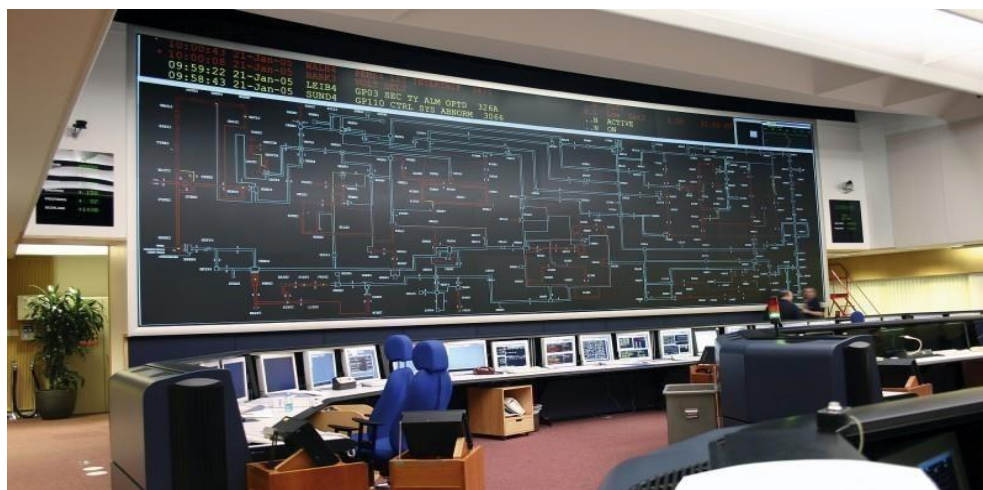
Figure II.16 : Poste de contrôle centralisée PCC.
