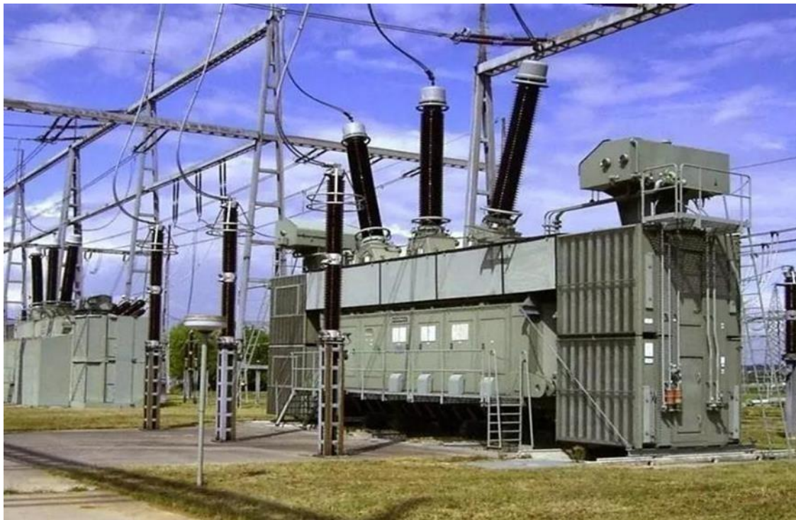
Figure II.1 : Poste de transformation de SONELGAZ à Mostaganem.
