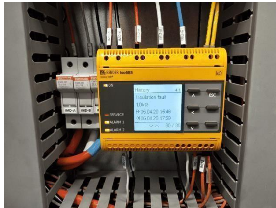
Figure III.6: Contrôleur permanent d'isolement.
