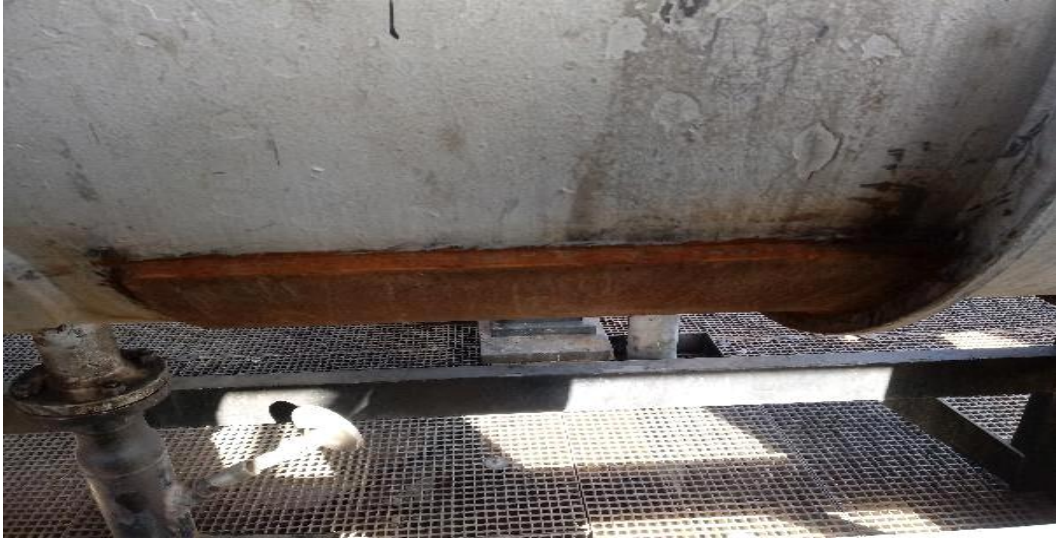
Figure IV-1 Patches de réparations sur la calandre E14 A
