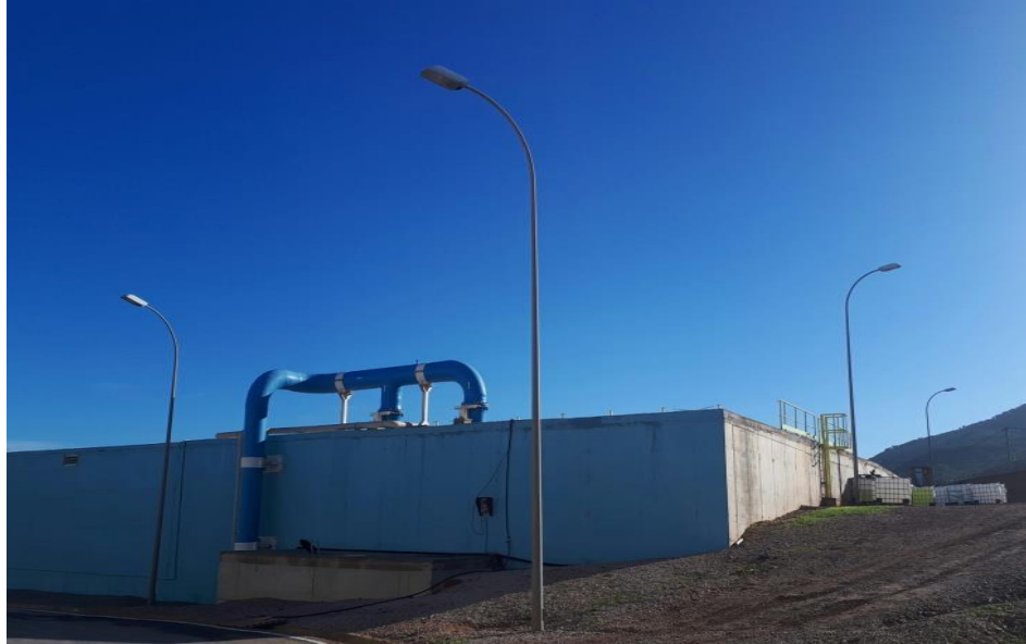
Figure 23. Injection de la chaux [Photo prise au niveau de la station de dessalement de Ténès 2023].
