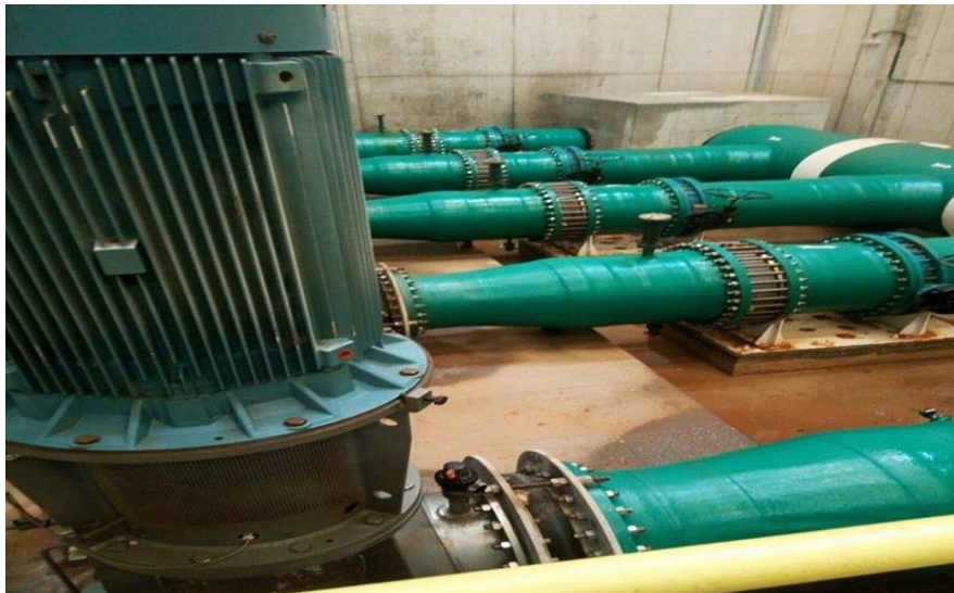
Figure 10. Pompe de captation de l'eau de mer
