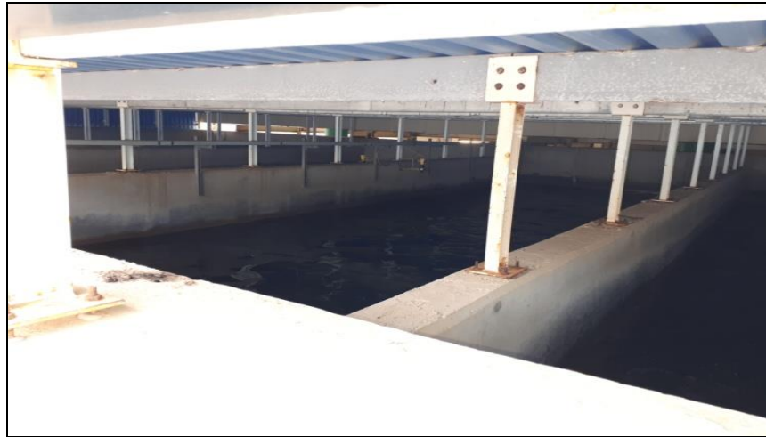
Figure 12. Filtres à sable (Photo prise au niveau de la station de dessalement de Ténès 2023)
