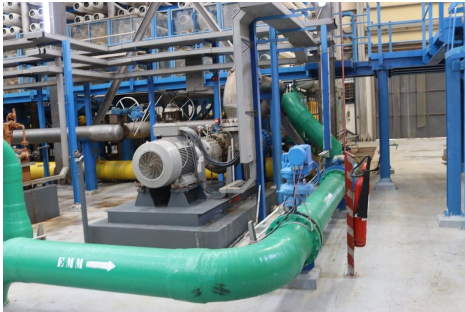
Figure 28. Bâtiment d'osmose inverse Station de dessalement de l'eau de mer Unité de Mostaganem (AEC - Algerian Energy Company www.aec.dz )
