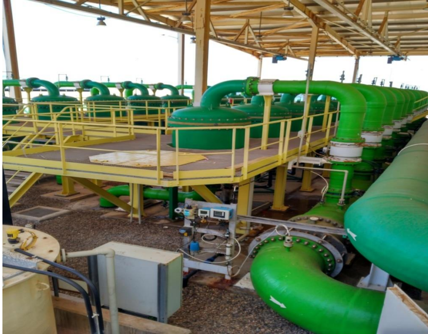
Figure 13. Filtres à cartouches [Photo prise au niveau de la station de dessalement de Ténès 2023].
