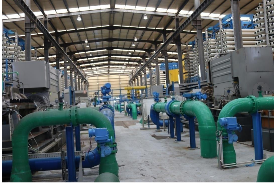
Figure 27. Filtres à cartouches Station de dessalement de l'eau de mer Unité de Mostaganem (AEC - Algerian Energy Company www.aec.dz )
