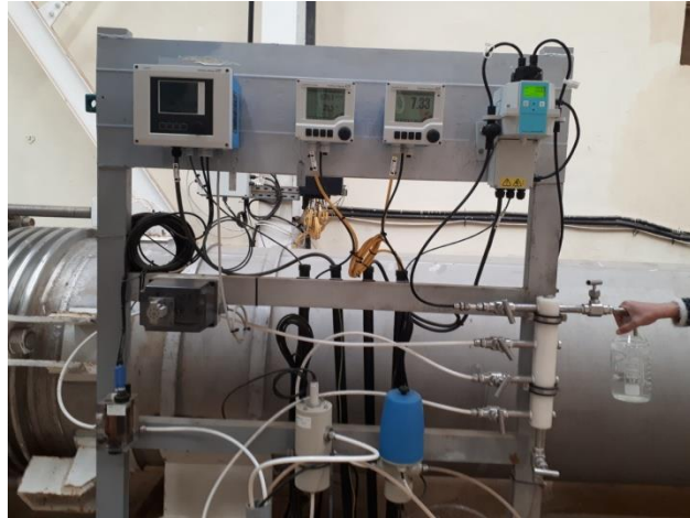
Figure 24. Analyseur automatique au niveau de sortie de Réservoir [Photo prise au niveau de la station de dessalement de Ténès 2023].
