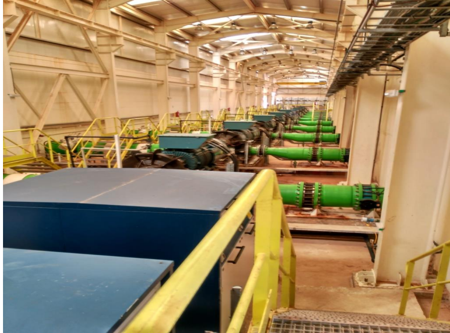
Figure 16. Pompe à Haut Pression [Photo prise au niveau de la station de dessalement de Ténès 2023]
