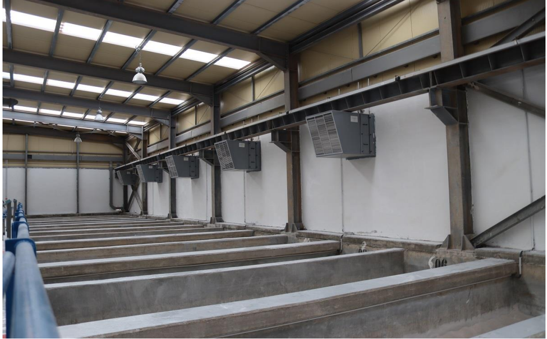
Figure 26. Filtres à sable Station de dessalement de l'eau de mer Unité de Mostaganem (AEC - Algerian Energy Company www.aec.dz )
