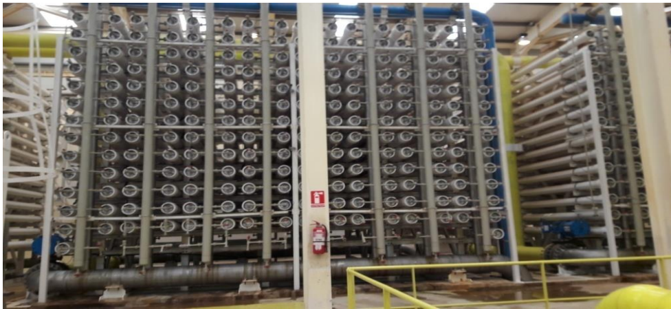
Figure 20. Un rack dans le système d'OI [Photo prise au niveau de la station de dessalement de Ténès 2023].
