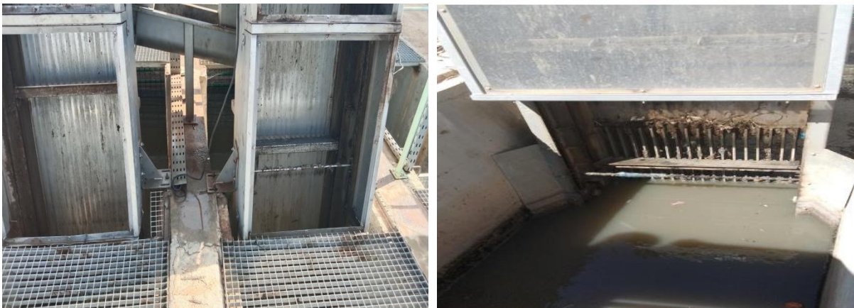
Photo. V.5. Dégrillage grossier (STEP Sidi Ali, 2024)
