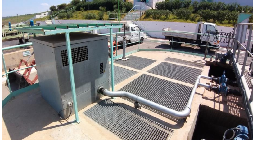
Photo. V.11. Compresseur (STEP Sidi Ali, 2024)
