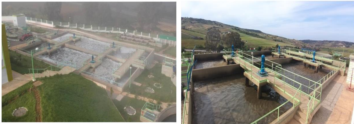
Photo. V.14. Les bassins d'aération (STEP Sidi Ali, 2024)
