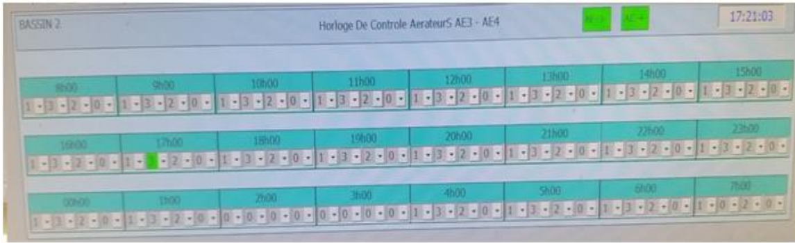
Photo. V.16. Horloge de contrôle aérateurs AE3 –AE4 (STEP Sidi Ali, 2024)
