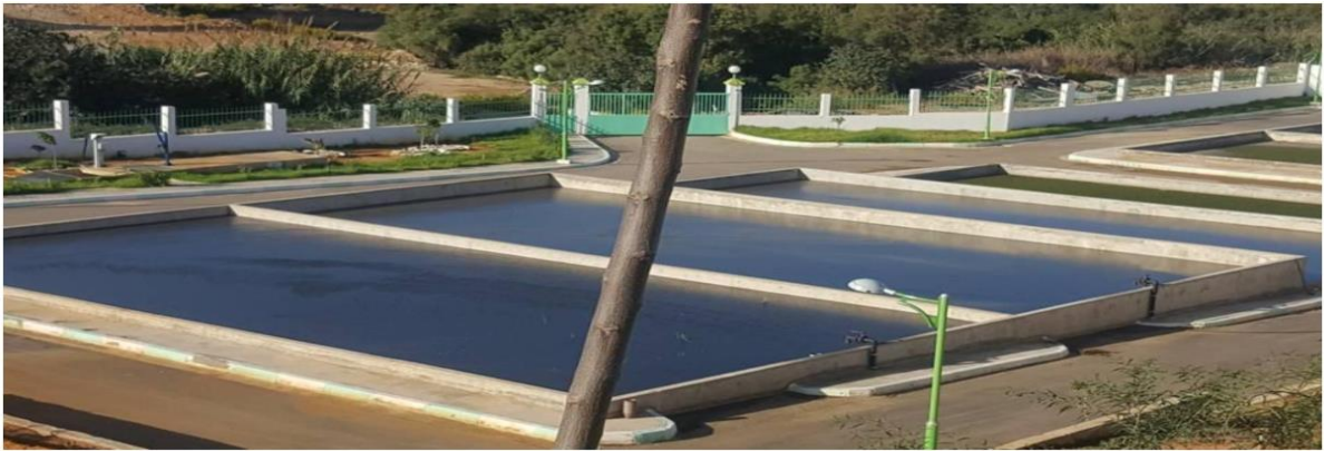
Photo. V.21. Lits de séchage (boues liquides) (STEP Sidi Ali, 2024)
