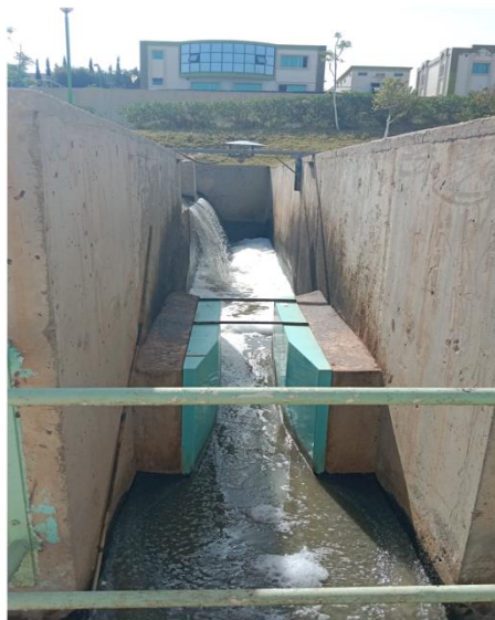
Photo.V.3. Canal venturi de comptage de débit (STEP Sidi Ali, 2024)
