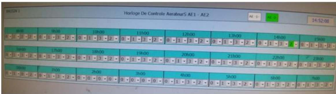
Photo. V.15. Horloge de contrôle aérateurs AE1 –AE2 (STEP Sidi Ali, 2024)
