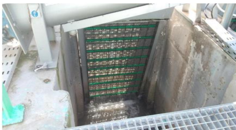
Photo. V.7. Dégrillage fin (STEP Sidi Ali, 2024)
