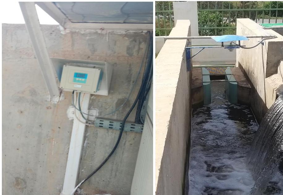
Photo .IV. 3. Le débitmètre a la sortie de la station (STEP Sidi Ali, 2024)
