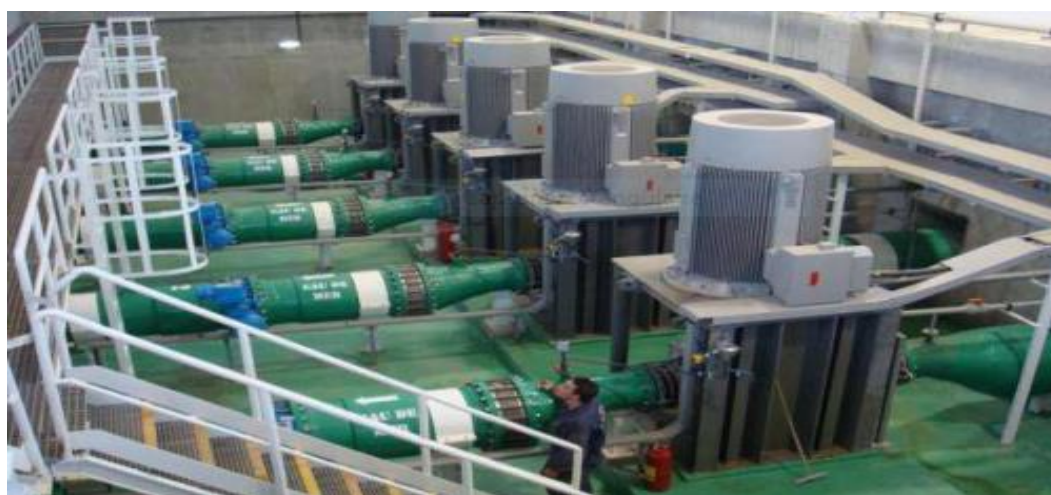
Figure 10 : Système de pompage de l'eau de mer (ZIANE B, BENFATMA A., 2023)
