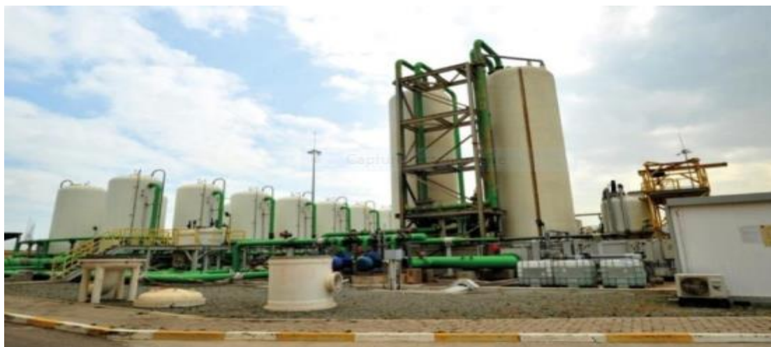
Figure 9 : Tours de captage et tuyauterie de captage (ZIANE B, BENFATMA A., 2023)
