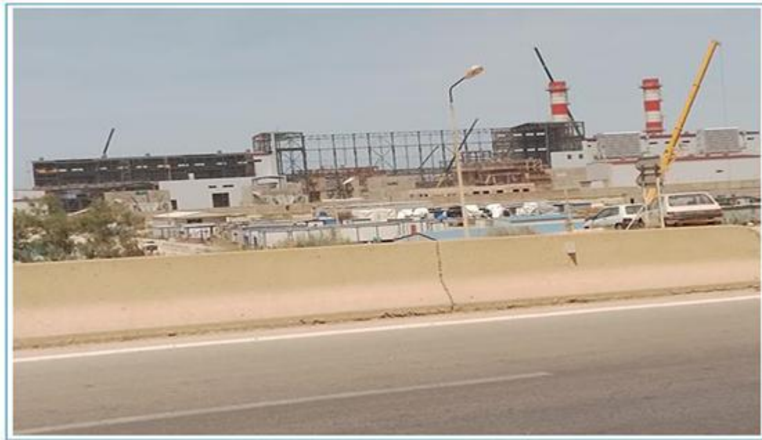
Figure. 6. Photos prises en 2023 sur l'unité de production de l'énergie électrique (Aizeb -Mostaganem).
